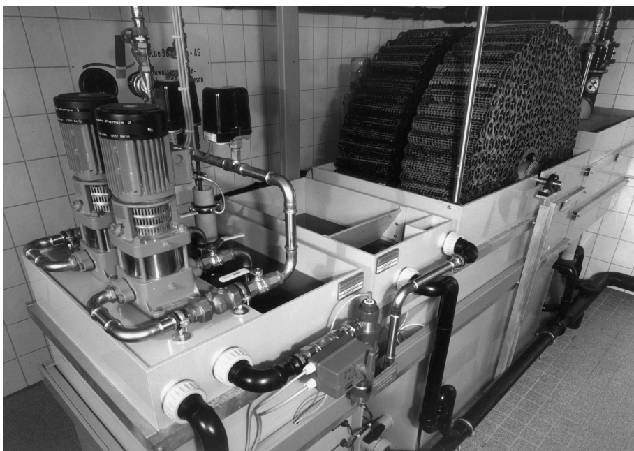
FIGURA 17 – L'IMPIANTO DI TRATTAMENTO DELLE ACQUE GRIGIE IN UN CONDOMINIO DEL CENTRO DI BERLINO
